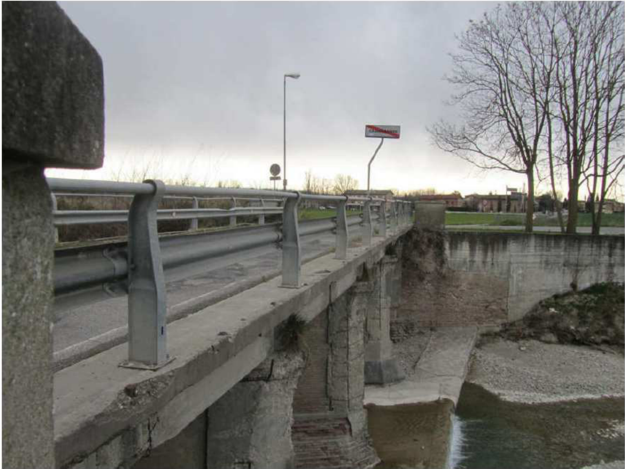
Stato attuale del ponte – dall'argine Sud, lato est con evidenza sui degradi
