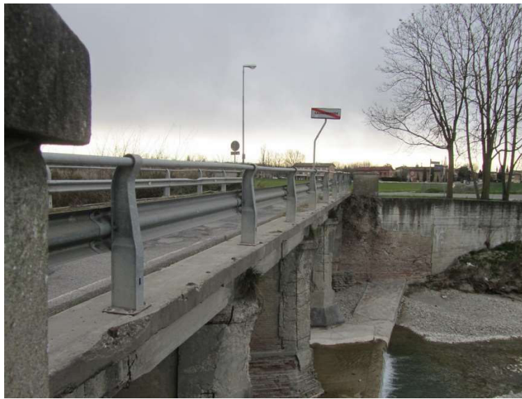
Stato attuale del ponte – dall'argine Sud, lato est con evidenza sui degradi
